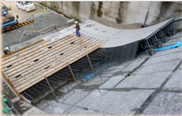
バケットカーブステンレスライニング
